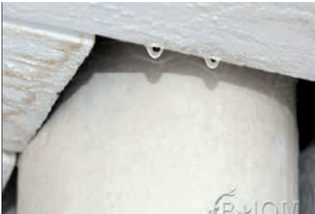
Condensatie door ontbrekende luchtdichting
