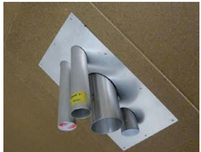
Een metalen afwerkplaat alleen is geen luchtdichting!
