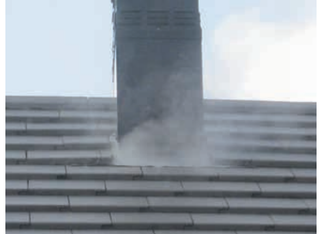
Rook langs de schoorsteen tijdens een luchtdoorlatendheidstest met lekdetectie
