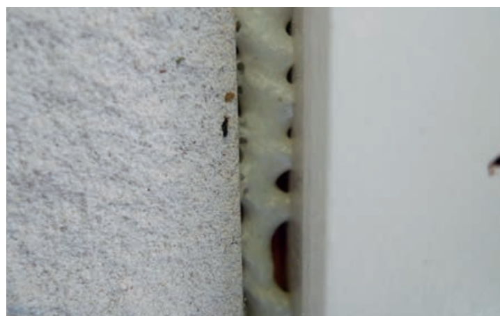
Voorbeeld van purschuim dat niet goed vullend is aangebracht.
